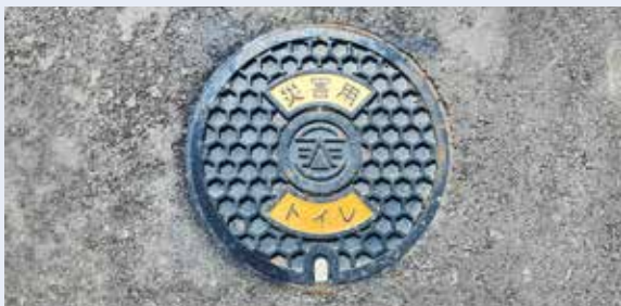
▲トイレが設置できるマンホール
