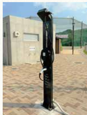
▲DMM EV CHARGE (春日西多目的広場公園)
