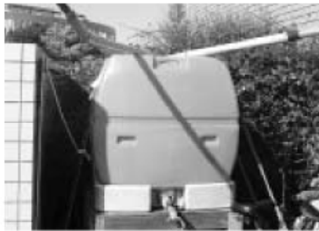
市役所に設置している雨水タンク
