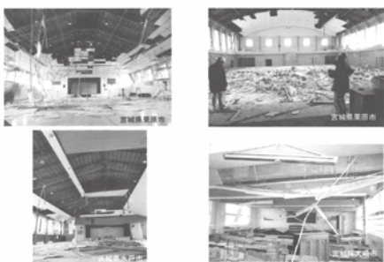
(非構造部材の被害状況) 天井材や照明器具の落下の被害
