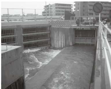
小倉第2雨水貯留施設
