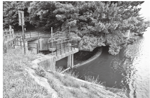
水位を調整する白水池の余水吐きゲート（排水門）
